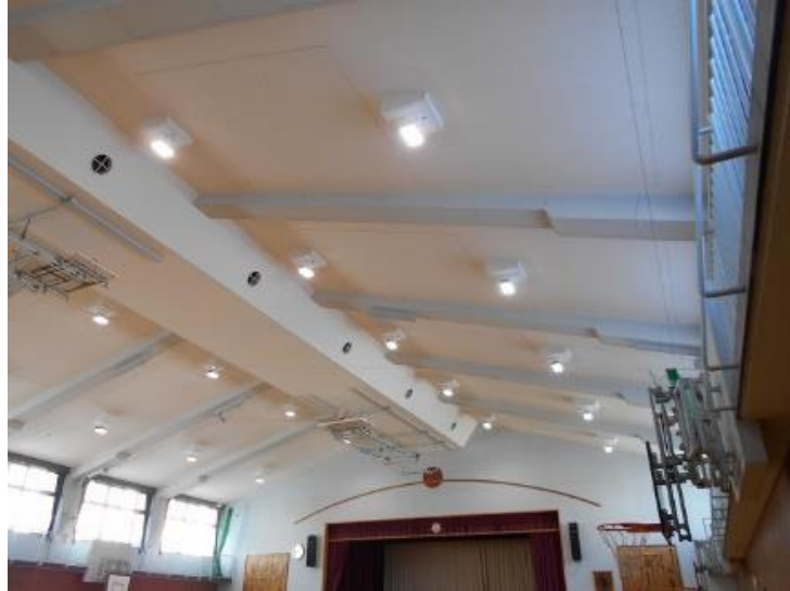
LED化した体育館の照明
