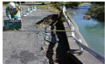
鱒淵川の護岸法崩れ (登米市東和町米川)
