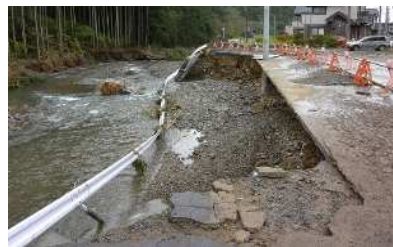
北沢川の護岸法崩れ (登米市津山町横山)
