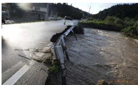
(主)北上津山線の法崩れ (登米市津山町横山)
