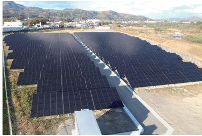
太陽光発電所(白石市)
