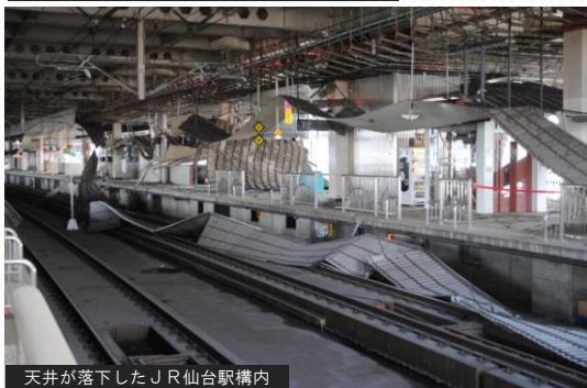
天井が落下したJR仙台駅構内
