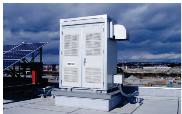
図 2- 131 蓄電池設備の設置事例
