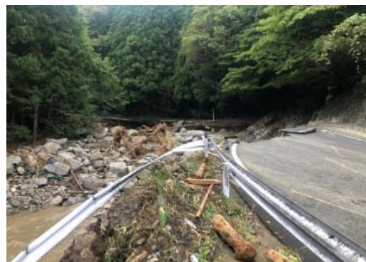
令和元年東日本台風被害 (道路)
