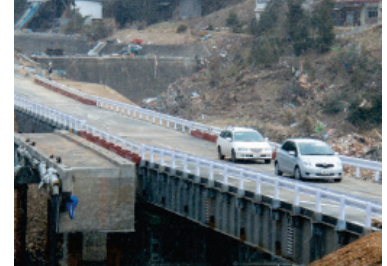
3 国道45号の二十一浜橋（気仙沼市）応急復旧（国土交通省東北地方整備局資料）
