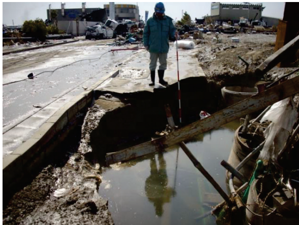
■写真 3-1-4：歩道陥没状況(工業地区)
