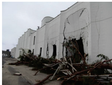
■ 写真 3-1-2：南蒲浄化センターの被災状況 (仙台市)
