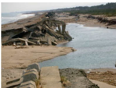
■ 写真 3-1-1：相ノ釜・納屋地区海岸の被災状況 (岩沼市)
