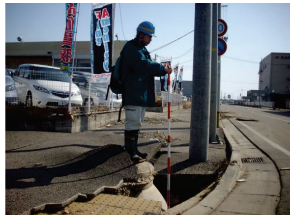
■写真 3-1-5：マンホールの隆起(流通地区)
