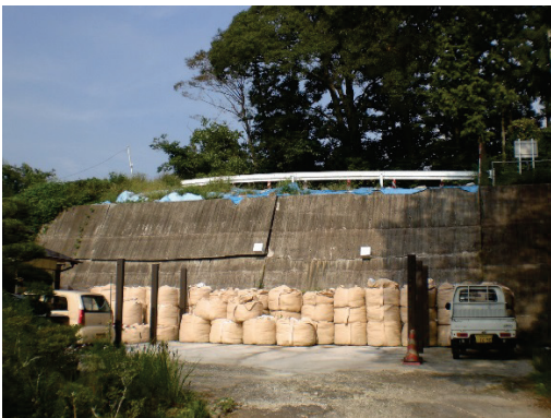
■写真 2-1-10：急傾斜地擁壁の被災状況（大崎市氷室地区）
