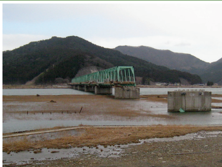
■ 写真 2-1-2：(国) 398号新北上大橋被災状況 (石巻市)
