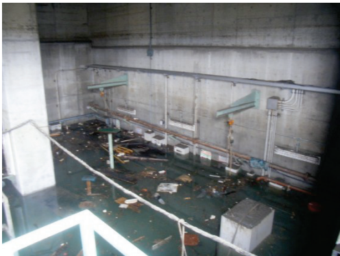
■写真 2-1-12：石巻東部浄化センター沈砂池被災状況（石巻市魚町）
