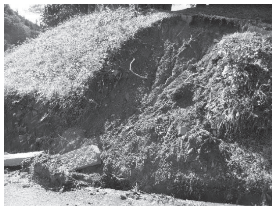
法面が崩壊した耕野小学校通学路
