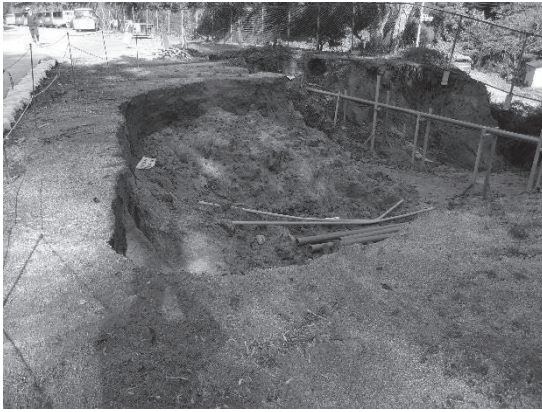
陥没，土砂流出した耕野小学校校庭
