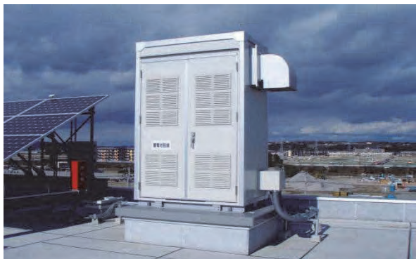
[写真：蓄電池設備の設置事例]
