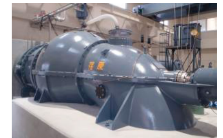
写真:五ヶ村堀排水機場のポンプ
