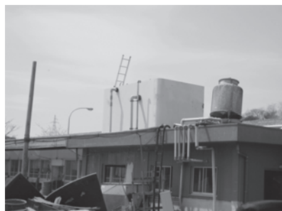
被災したかき処理場
