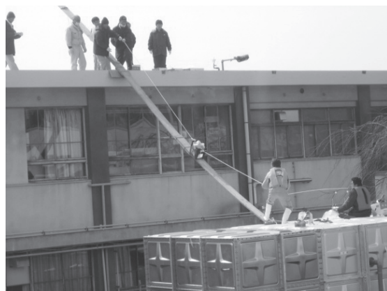
受水槽からの水の汲み出し
