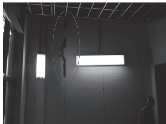
茂庭浄水場薬品処理館の被災状況
