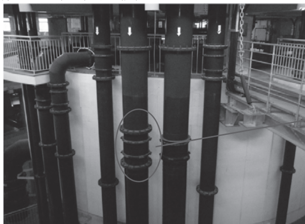
薬品処理館内管路の被害
