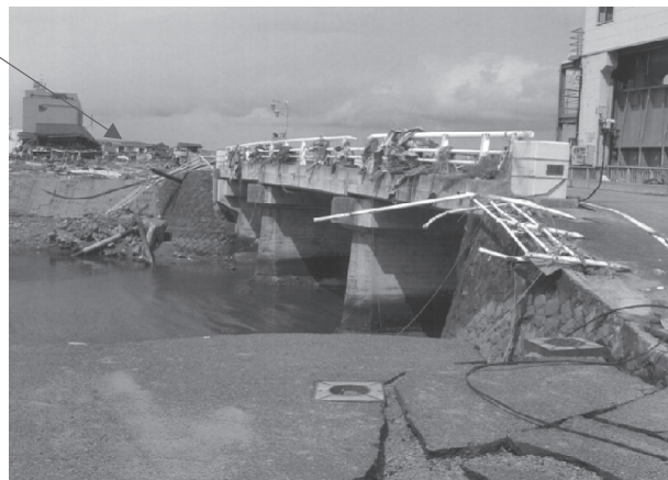
被災後の状況(水管橋が流失した)
