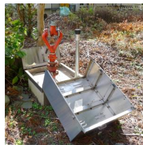
防火設備（放水銃）
