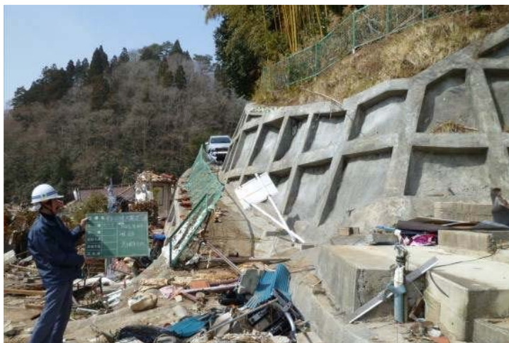
唯越急傾斜地（気仙沼市唐桑唯越地内）23年3月20日撮影
