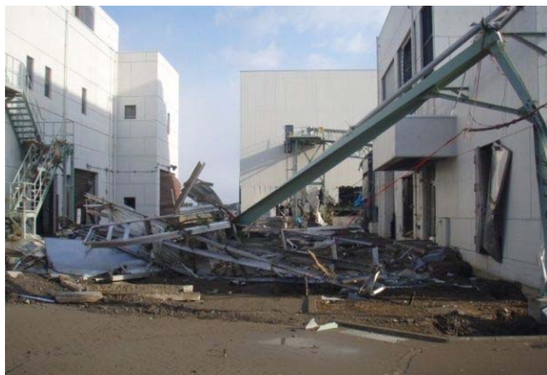
県南浄化センター脱水機棟 (岩沼市下野郷地内)
