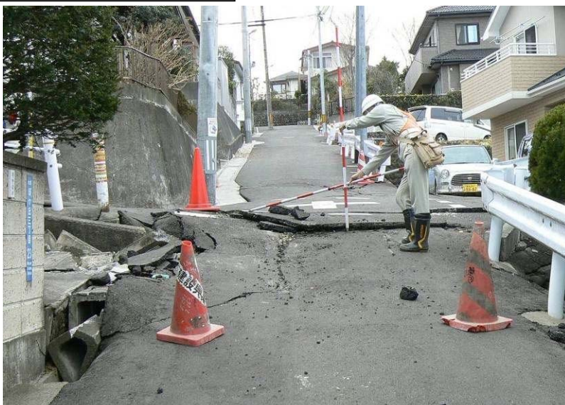
地すべり（仙台市太白区緑ヶ丘地内）
