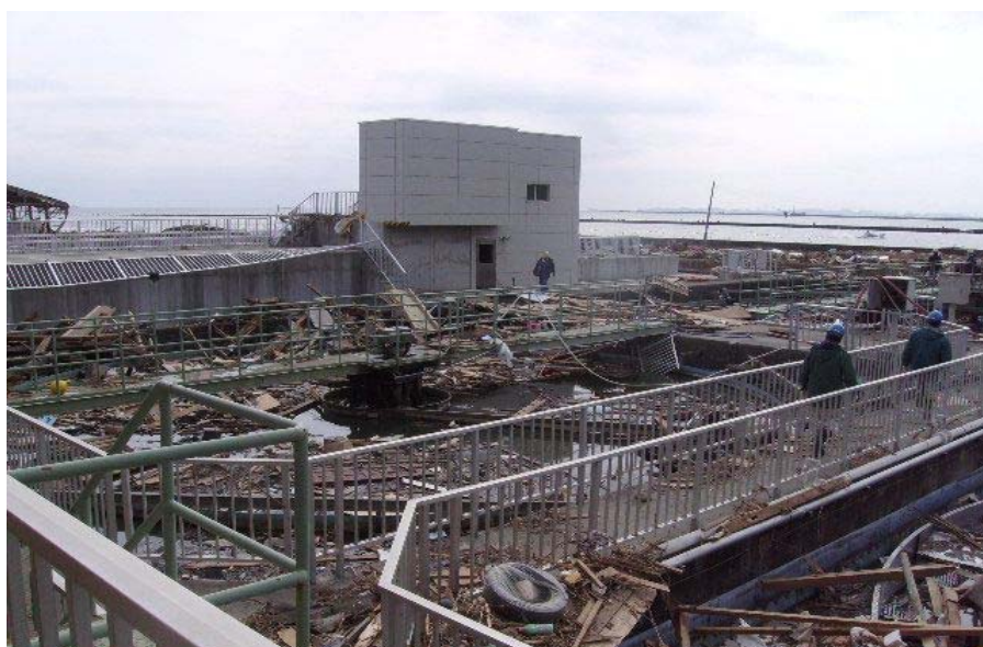
東部浄化センター下水処理施設（石巻市魚町地内）
