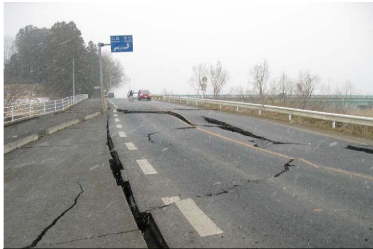
国道 346 号（登米市米山町櫓場場内）平成 23 年 3 月 11 日撮影
