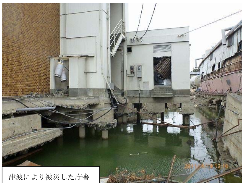
津波により被災した庁舎
