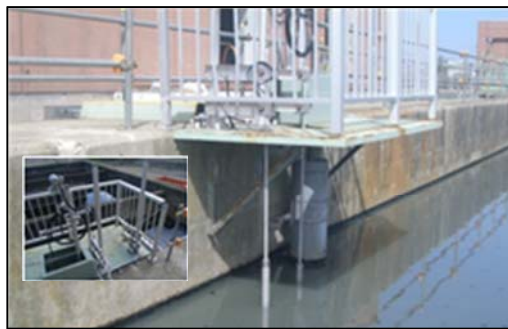
▲放流水質測定装置設置状況
