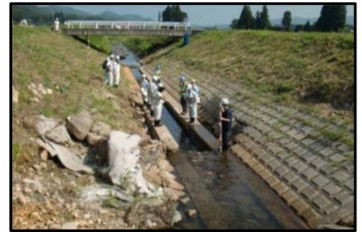
災害査定状況
