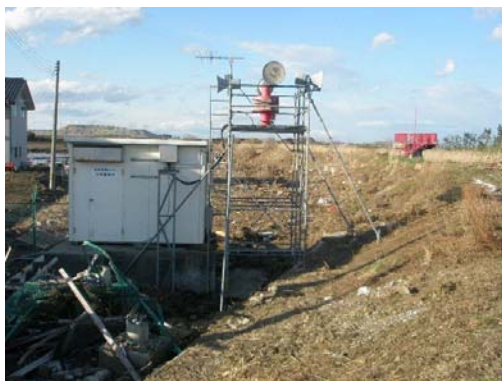
▲ 寺野警報所 復旧前 仮設の槽にサイレン、スピーカ等を設置
