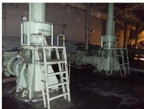
補機類の浸水により機能停止
