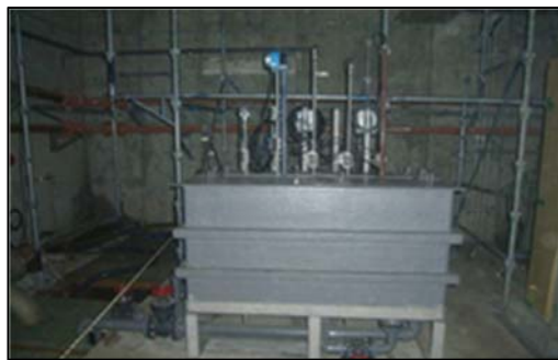
▲流入水質測定装置設置状況
