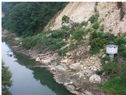
▲ 白沢河川水位観測所 復旧前 崖の崩落により観測所の機能停止
