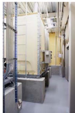
新設した受水槽
