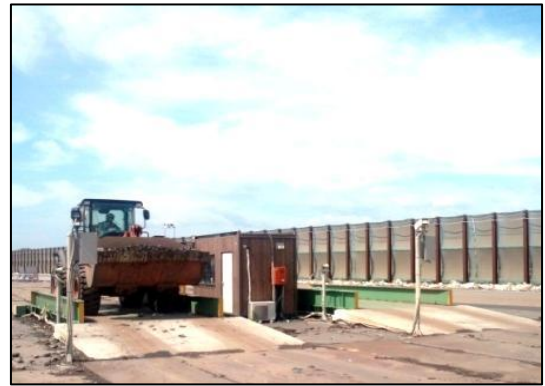
写真6-17 可燃物用トラックスケール
