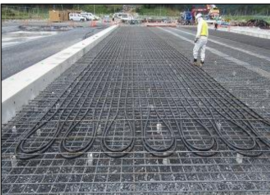
写真3-42 乾燥テント床版温水配管
