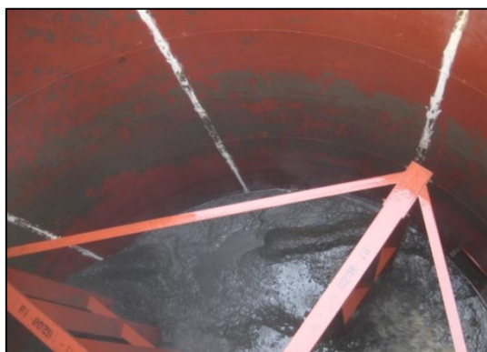
写真3-52 スラリー槽状況
