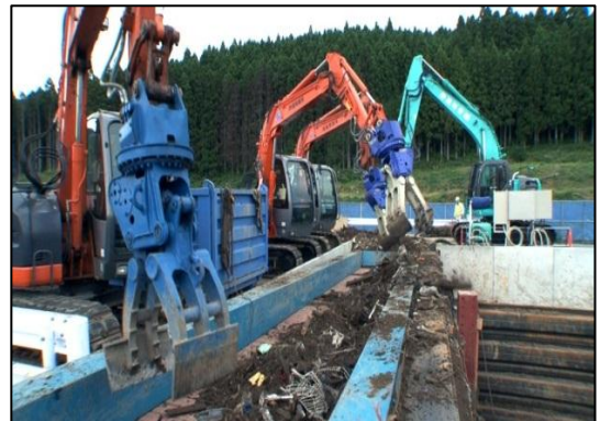
写真3-16 受入施設 重機選別状況
