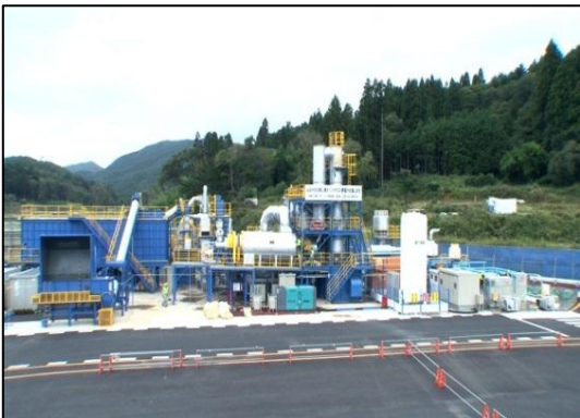
写真3-40 バイオマス施設全景
