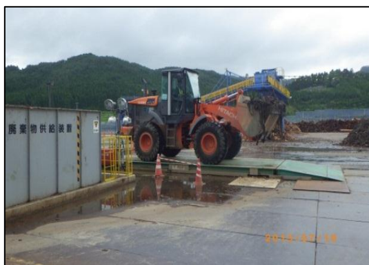
写真3-27 焼却物投入前計量状況
