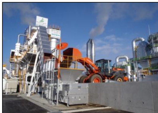
写真2-23 焼却物投入状況
