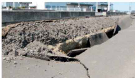
写真：用排水路の沈下(栗原市)
