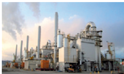
写真:亘理名取ブロック 災害廃棄物焼却施設(亘理町)
