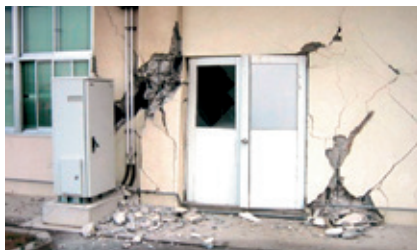
写真：壁や柱が崩落し使用不能となった志波姫総合支所（栗原市）
