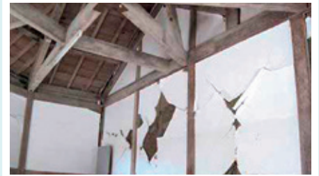
写真：壁が崩壊した教育資料館(登米市)
