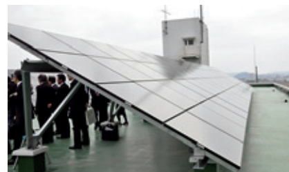
写真:公共施設に導入された太陽光発電システム(仙台市)
