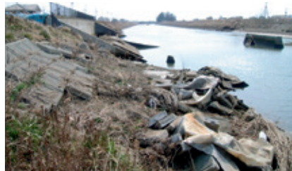
写真：震災後の増田川堤防(名取市)
