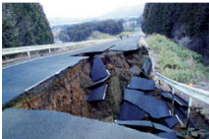
写真：震災後の道路(白石市)
