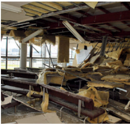
写真:運転免許センター(石巻市)
