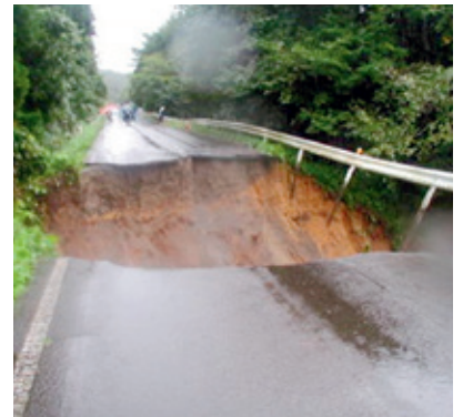
写真: 崩落した国道457号(川崎町)
