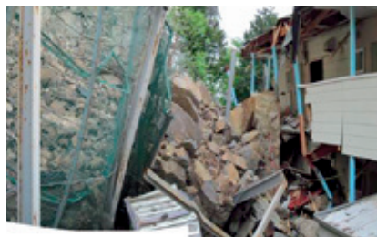
写真：震災後の砂防施設(石巻市)
