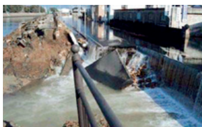
写真：震災後の砂押川堤防(多賀城市)
