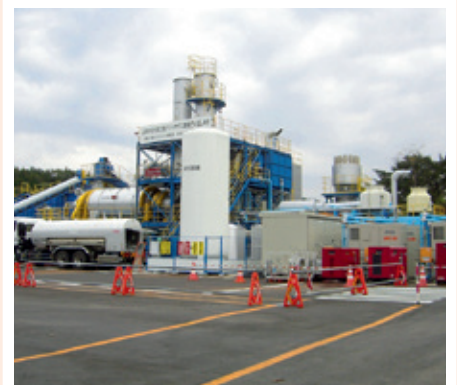
写真:木質バイオマス発電施設(南三陸町)
