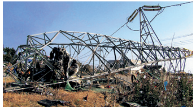
写真：津波で倒壊した送電鉄塔(仙台市)
