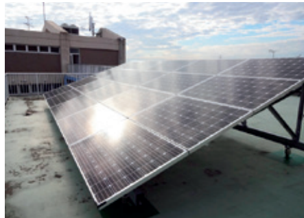
写真: 公共施設に設置された太陽光発電設備(七ヶ浜町)
