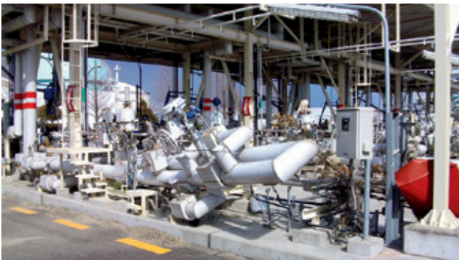
写真：被災したガス供給施設(仙台市)
