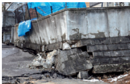
仙台市(崩れた擁壁)
