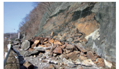
川崎町(がけ崩れが発生した道路)
