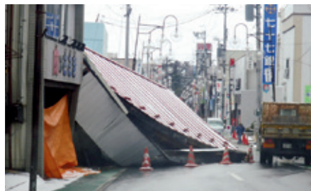
登米市(倒壊した住宅)
