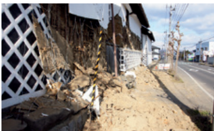
大河原町(崩壊した土倉の壁)
