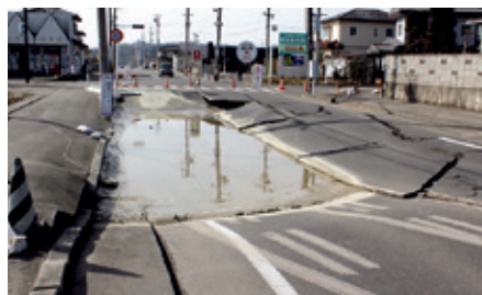
柴田町(陥没した道路)
