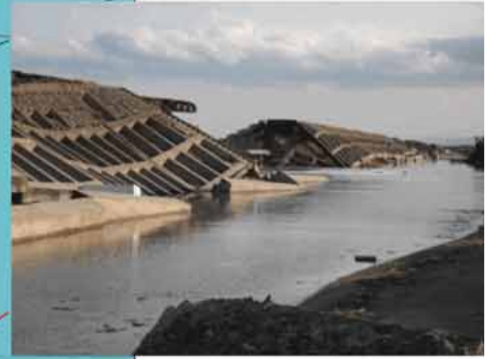
岩沼市二の倉海岸の被害状況
