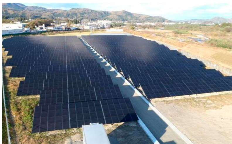
「再生可能エネルギー大規模導入プロジェクト」の第1号として運転を開始した白石太陽発電所(白石市)
