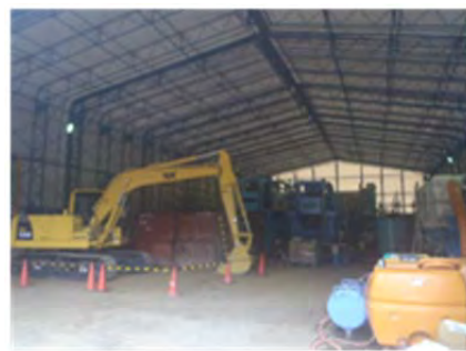
写真7 仮設脱水機施設内部
