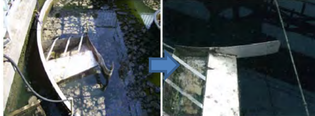
変形・破損したNo.1最終沈殿池 汚泥掻寄機のスカムボックス及びNo.4最終沈殿池汚泥掻寄機のスカムパイプが復旧した
