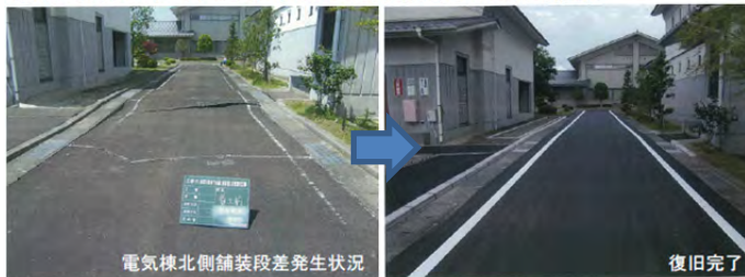
被災した浄化センター内の道路及び水処理施設管廊目地等が復旧復旧した
