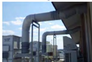
石越浄化センター排気ダクト完成 (H24年7月)
