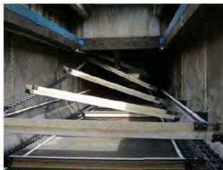
脱落した最終沈殿池の搔寄機
