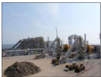
焼却炉稼働時の状況 (石巻ブロック)
