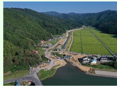
①加茂川河川改修工事 ②石巻市福地地内 ③築堤盛土及び樋門・護岸工を 施工中 ④73%
