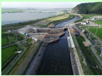
①富士川外1河川災害復旧工事 ②石巻市針岡地内外 ③堰工事及び樋管工事を 施工中 ④81%
