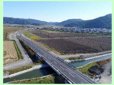
①国道398号石巻バイパスⅡ期工事 ②石巻市大瓜地内 ③全線供用中 側道 部施工中 ④97%
