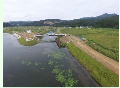
①追波沢川外災害復旧工事 ②石巻市北上町十三浜字江川地内外 ③第二吉浜橋を施工中 ④98%
