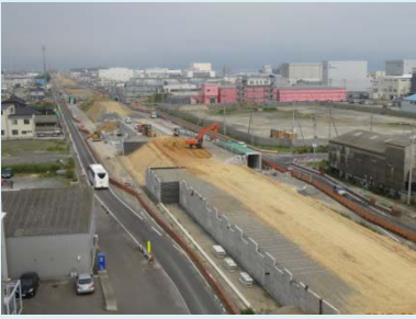
①門脇流留線道路改築工事 ②石巻市門脇～魚町 ③魚町工区において本線部補強土壁工施工中 ④30%
