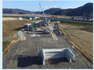
①国道398号石巻バイパスⅡ期工事 ②石巻市大瓜地内 ③真野川橋梁、大和田川橋梁の下部工完了 ④78%
