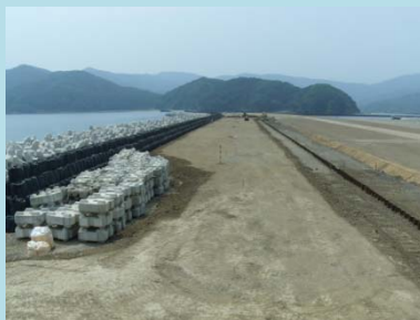
①横須賀地区海岸災害復旧工事 ②石巻市長面地内 ③盛土工を施工中 ④72%
