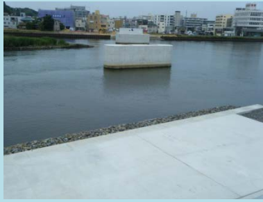
①国道398号内海橋災害復旧工事 ②石巻市中央地内 ③下部工施工完了 上部工桁工場製作中 ④46%
