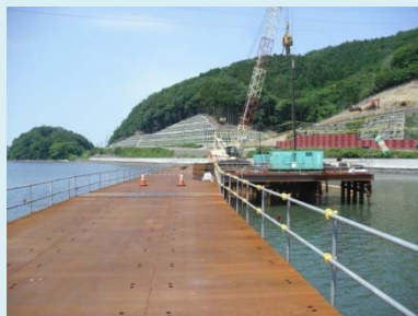
①浦宿道路改良工事 ②女川町浦宿浜地内 ③浦宿地区で仮設防護柵工を施工中 ④14%
