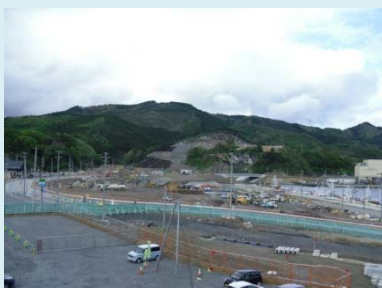
①国道398号女川市街地道路改良工事 ②女川町女川浜地内 ③女川浜地区で路体盛土を施工中 ④50%
