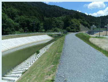
①富士川外1河川災害復旧工事 ②石巻市針岡地内外 ③針岡地区で築堤工事及び護岸工を施工中 ④63%
