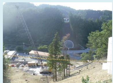
①小乗浜復興道路工事 ②女川町小乗浜地内 ③小乗浜地区でトンネルと橋梁下部工を施工中 ④32%
