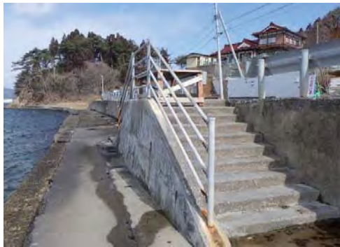
⑱ 亀山磯草地先海岸（４－１工区）気仙沼市磯草地内 災害復旧事業／沈下／海岸堤防工
