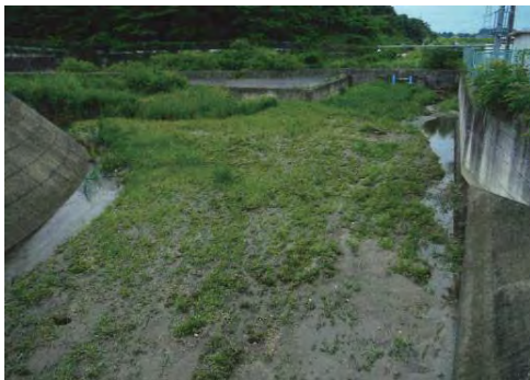
⑤ 化女沼ダム 大崎市古川雨生沢地内 ダム修繕事業／堆積土砂撤去工
