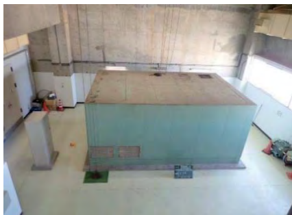
② 石巻東部浄化センター 石巻市魚町一丁目地内 No. 2汚泥脱水設備改築工事
