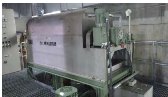
写真2. 汚泥濃縮機本体
