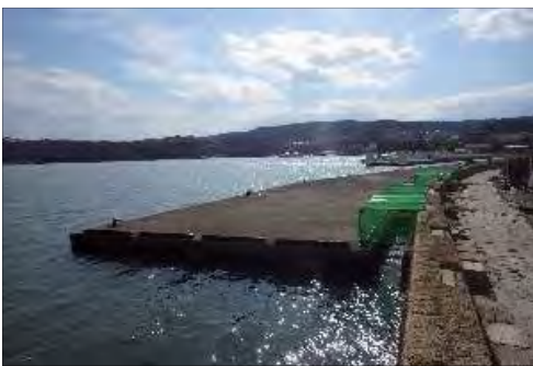
⑪ 仙台塩釜港(松島港区) 宮城郡松島町仙随地先外 仙随胸壁災害復旧外(その2)工事
