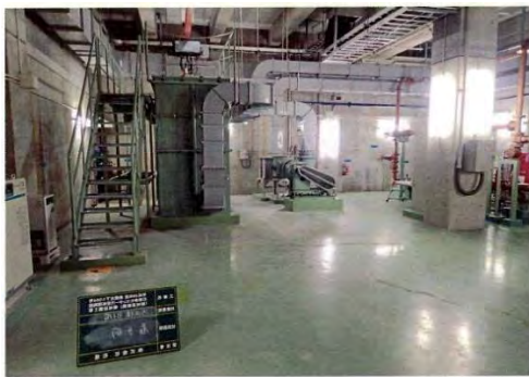
① 石巻浄化センター 石巻市蛇田字新メ切地内 汚泥処理施設（機械濃縮機）機械設備 2期工事
