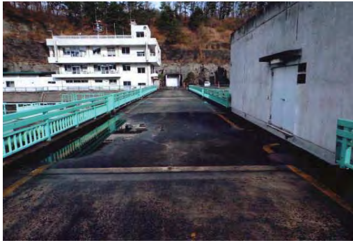
③ 漆沢ダム 加美町字漆沢宮ヶ森地内 ダム修繕事業／浸水対策工
