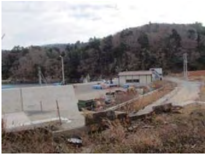
③ 女川港海岸女川港（高白地区）女川町横浦地内外 横浦防潮堤外災害復旧（その2）工事
