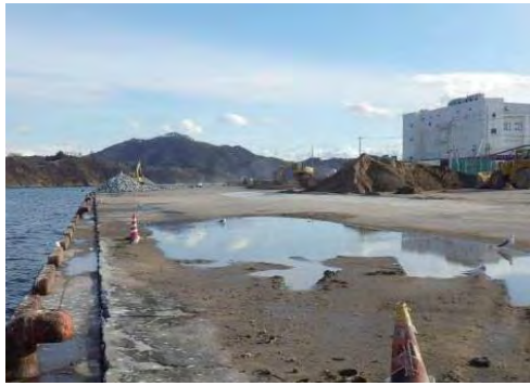
㉗ 気仙沼港（朝日地区） 気仙沼市朝日町地内 災害復旧事業／沈下欠壊／－7.5m岸壁工
