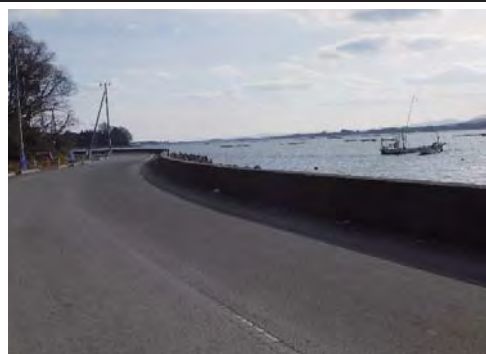
⑳ 磯草地先海岸 気仙沼市磯草地内 災害復旧事業／沈下／護岸工
