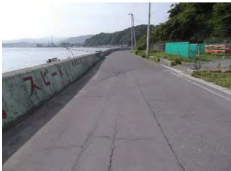
㊿ 気仙沼港海岸（小々汐）気仙沼市小々汐地内 災害復旧事業／沈下欠壊／護岸工
