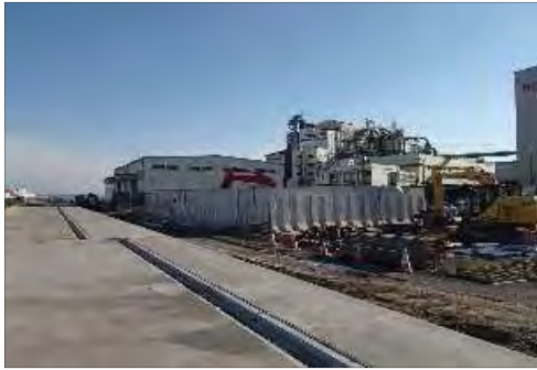
⑥ 仙台塩釜港(塩釜港区) 塩竈市貞山通一丁目地内 貞山ふ頭防潮堤外工事
