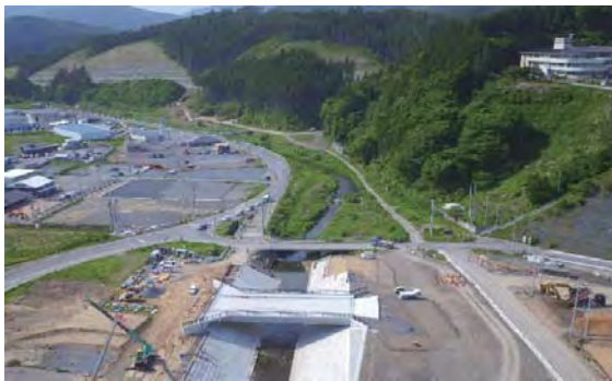
⑤ 国道398号 南三陸町志津川字御前下地内 志津川復興道路事業
