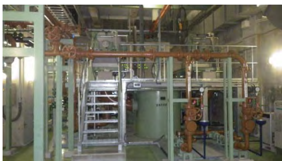
写真1. 汚泥濃縮機全景
