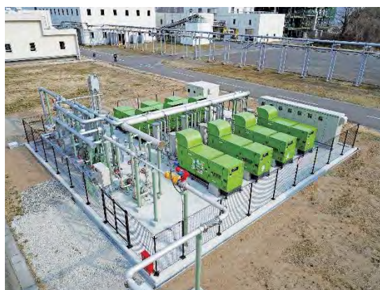
仙塩浄化センター消化ガス発電所
