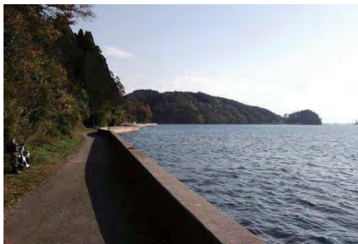
㊿ 気仙沼港海岸（梶ヶ浦）気仙沼市二ノ浜地内 災害復旧事業／沈下／護岸工
