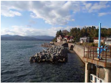
⑨ 高井浜大向地先海岸 気仙沼市 高井浜大向地先海岸災害復旧工事
