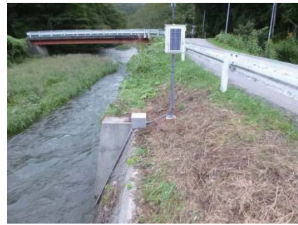
危機管理型水位計設置状況 (馬籠川(気仙沼市))
