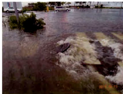
H27. 9. 11 仙台幹線（岩沼市）溢水状況
