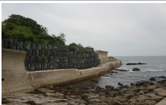
⑤ 松ヶ浜海岸 七ヶ浜町松ヶ浜地内 海岸堤防沈下欠壊
