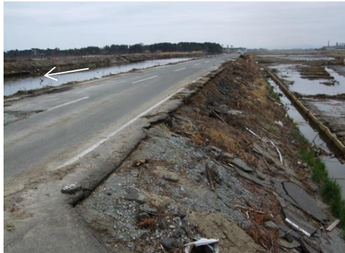
② 南貞山運河 岩沼市下野郷地内 河川堤防沈下決壊
