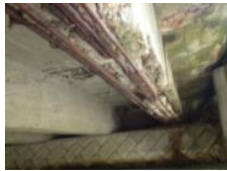
損傷状況（コンクリートが剥離し主筋が露出）
