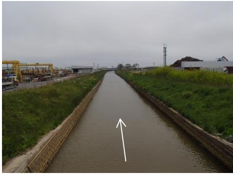
① 川内沢川 岩沼市下野郷地内 河川堤防沈下
