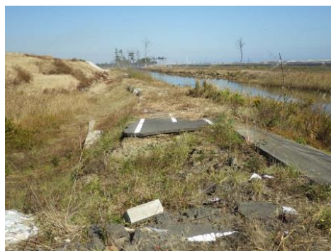
⑧ 南貞山運河(七北田川水系) 仙台市宮城野区蒲生地内 河川堤防沈下決壊
