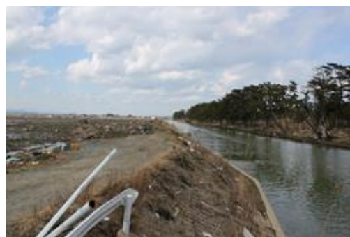
⑭ 五間堀川 岩沼市寺島（新浜橋） 河川堤防沈下欠壊
