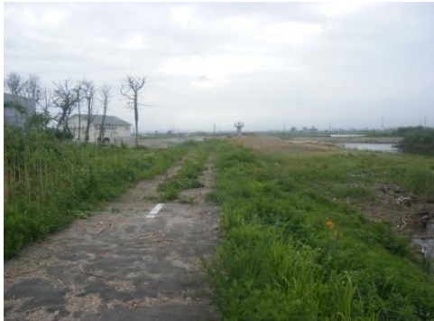
⑦ 七北田川 仙台市宮城野区蒲生地内 河川堤防沈下決壊
