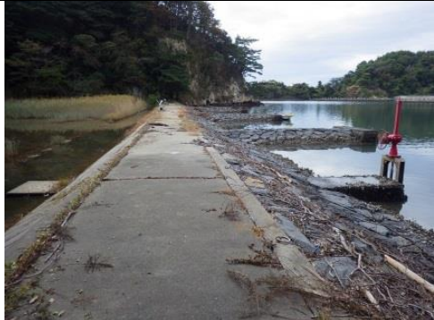
⑪ 朴島地区海岸 塩竈市浦戸野々島字朴島地先 海岸堤防復旧工事
