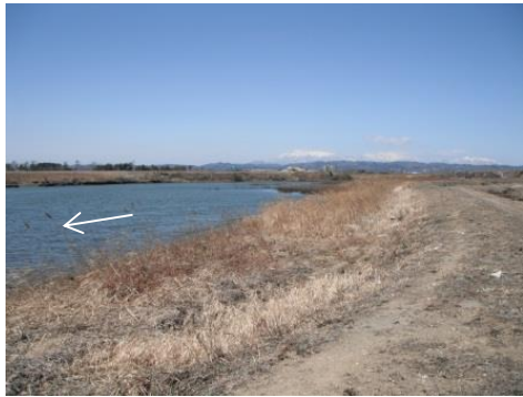
③ 増田川 名取市小塚原地内 河川堤防沈下
