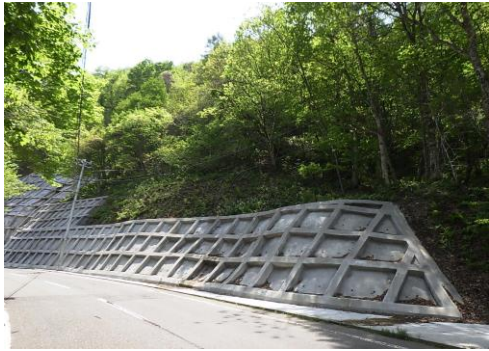
⑥ (主) 築館栗駒公園線 栗原市栗駒沼倉地内 沼倉災害防除
