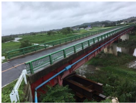
③ 西川橋 大和町鶴巣大平地内 伸縮装置，支承の損傷，両橋台せん断破壊
