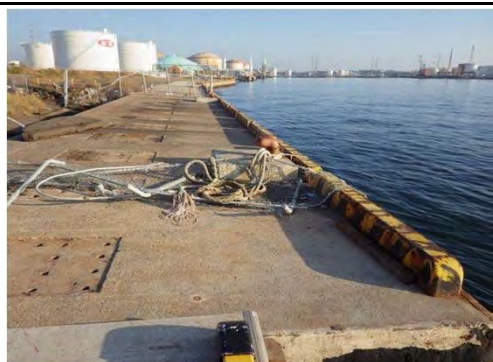
仙台塩釜港仙台港区 仙台市宮城野区港四丁目地内 北航路西C護岸沈下
