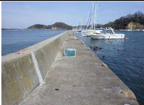
仙台塩釜港塩釜港区 七ヶ浜町東宮浜地内外 東宮浜東防波堤沈下
