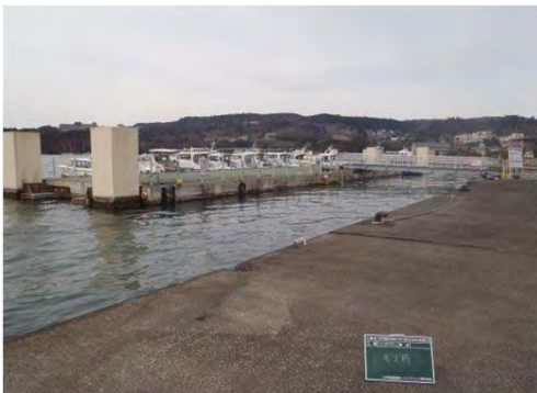
仙台塩釜港松島港区 宮城郡松島町松島仙随地先 仙随(B)48m浮き棧橋係留杭，渡橋橋台沈下
