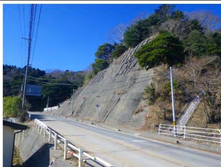
鮎川浜 石巻市鮎川浜地内 道路法面对策 着工前（劣化状況）
