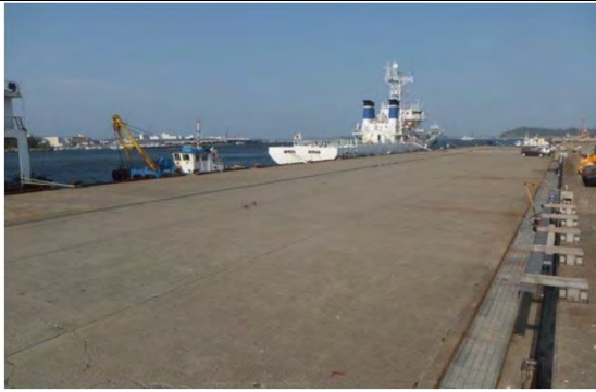
仙台塩釜港塩釜港区 塩釜市港町一丁目地先外 西心頭棧橋沈下
