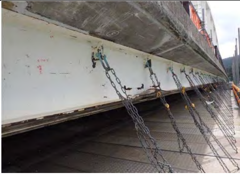
万石橋 石巻市渡波地内 橋梁上部工の破損
