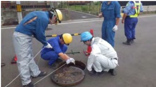
写真3. 水質計設置状況
