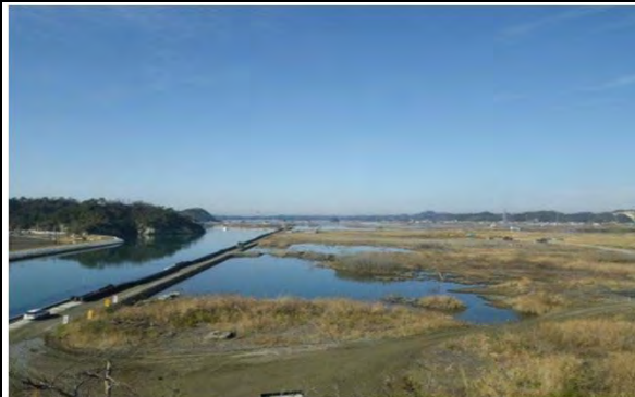
平成26年10月 州崎海岸 東松島市野蒜字洲崎地内 海岸堤防沈下
