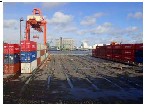
仙台塩釜港仙台港区 仙台市宮城野区港地内 高砂野積場沈下
