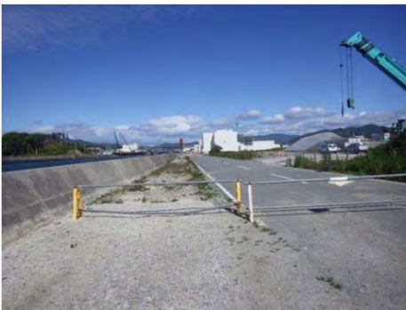
気仙沼港朝日町地区 気仙沼市朝日町地内 海岸堤防沈下欠壊
