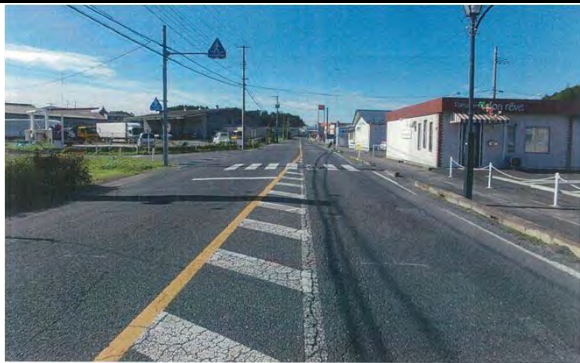
登米市迫町小金丁地内（新表前工区） 小金丁外舗装補修工事
