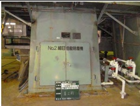
岩沼市下野郷地内 県南浄化センターNo.2細目自動除塵機修繕工事
