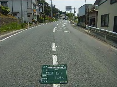
国道346号 気仙沼市本吉町津谷松岡地内 舗装面の亀甲クラック，段差
