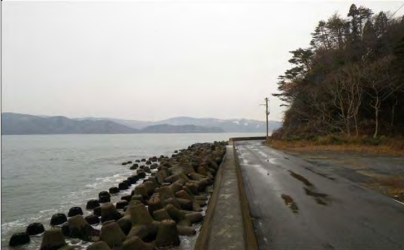
平成26年3月 白浜海岸 石巻市北上町十三浜地内 海岸堤防沈下
