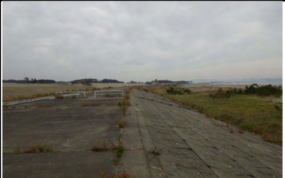
平成25年4月 東名海岸 東松島市大塚地内 海岸堤防沈下決壊
