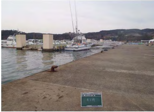
仙台塩釜港松島港区 宮城郡松島町松島仙随地先 仙随(A)48m浮き棧橋係留杭，渡橋橋台沈下
