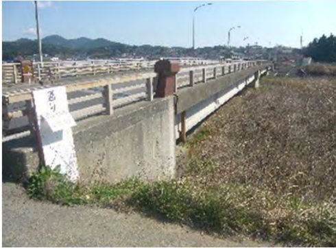
(国)346号 気仙沼市本吉町新明戸地内 花見橋の高欄，伸縮装置等の劣化・損傷
