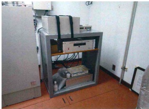
水位観測局 加美郡加美町字薬師堂外 並柳水位観測局外水位計等改良工事
