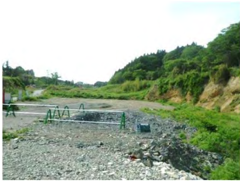
登米沢地区海岸 気仙沼市本吉登米沢地先 海岸堤防沈下欠壊
