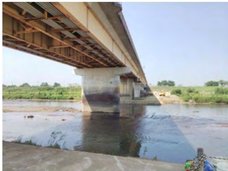
一般県道若柳花泉線 栗原市若柳地内 若柳第二大橋耐震補強工事
