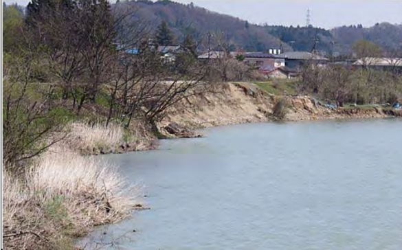
江合川 大崎市岩出山上野目地内 河川堤防 法欠 被災後
