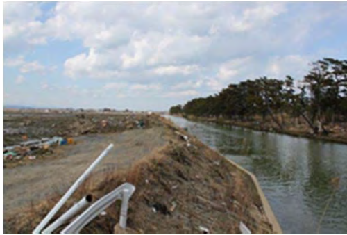
五間堀川 岩沼市寺島（新浜橋） 河川堤防沈下欠壊
