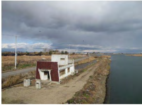
増田川 名取市下増田地内 河川堤防沈下欠壊
