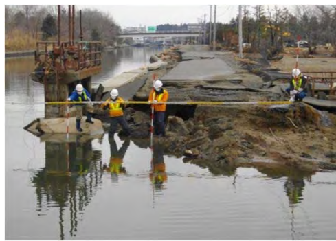
砂押川 多賀城市大代地内 河川堤防沈下決壊
