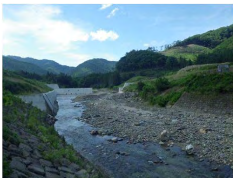
迫川 栗原市花山字本沢小川原地内 小川原砂防えん堤工事
