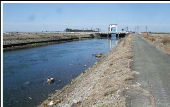
中貞山運河 名取市関上地内 河川堤防沈下欠壊
