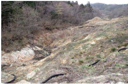
佐手川砂防事業（災害関連緊急砂防事業） 溪岸山腹斜面の崩壊
