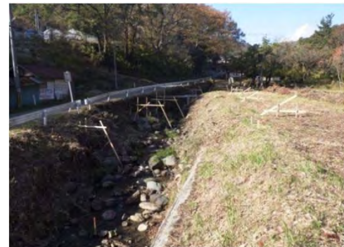
(-) 越河角田線 丸森町耕野地内 道路改良事業(道路拡幅部河川護岸)
