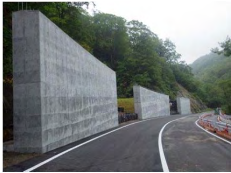
国道398号 栗原市花山字本沢岳山地内 湯浜スノーシェッド(下部工)工事
