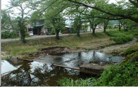
湯沢川 大崎市鳴子温泉川渡地内 河川堤防 法欠 被災後
