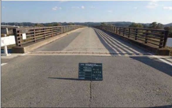
志田橋撤去 大崎市古川下中目地内 旧志田橋撤去直前（古川側から望む）
