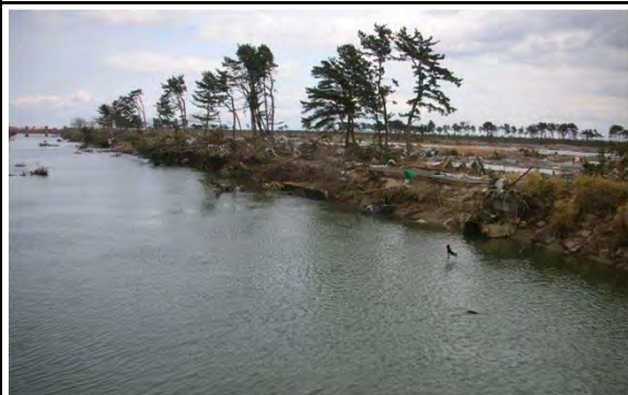
南貞山運河 名取市増田・岩沼市下野郷地内 河川堤防沈下欠壊
