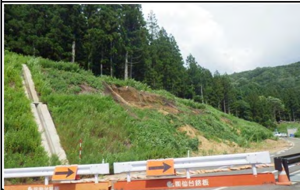
国道347号 加美町嶽山地区 災害防除 着手前
