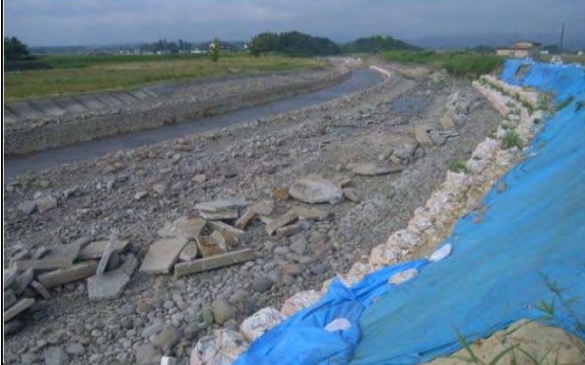
花川 色麻町四竈字大坊地内 河川堤防護岸被災後
