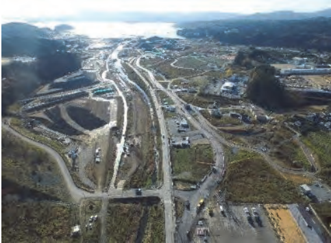
④ 八幡川 南三陸町志津川字廻館地内 八幡川河川災害復旧工事
