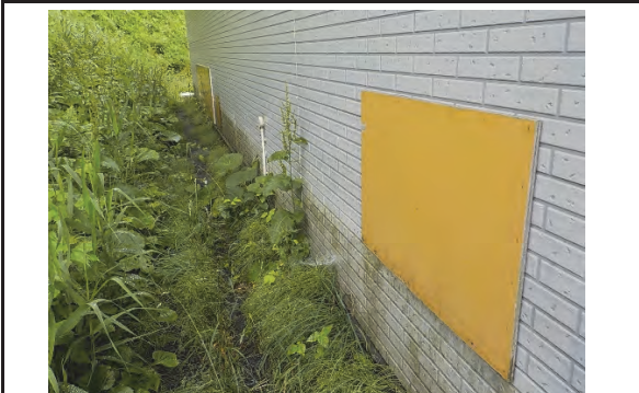
⑤ 上大沢ダム 大崎市鳴子温泉鬼首字上大沢地内 上大沢ダム管理事務所外壁改修工事
