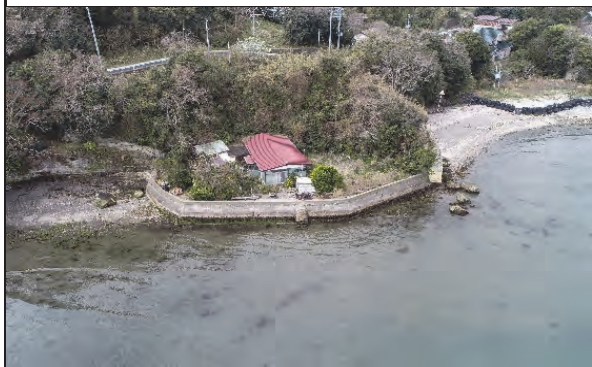
⑤ 仙台塩釜港（塩釜港区）塩竈市浦戸石浜本石浜地内 石浜護岸外災害復旧工事
