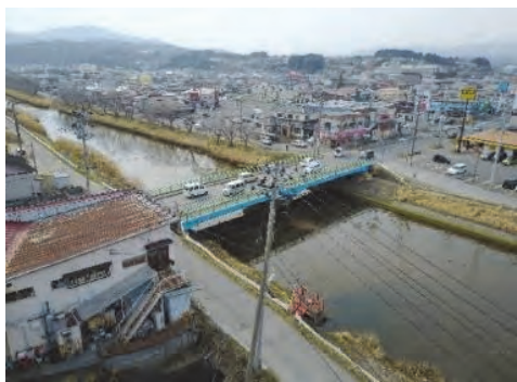
⑦ (主)気仙沼唐桑線 気仙沼市神山地内外 河川災害復旧事業 (神山川橋)
