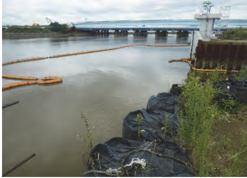
⑥ 仙台塩釜港石巻港区海岸重吉地区 石巻市重吉地内 重吉地区防潮堤（その3）外工事
