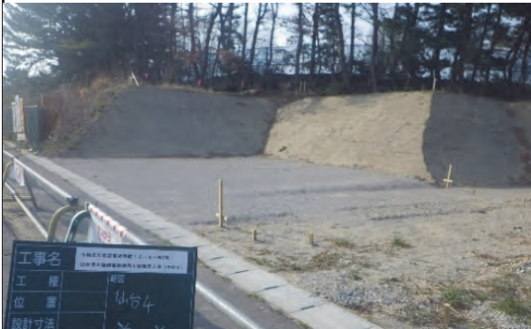
② 仙台塩釜港（仙台港区）仙台市宮城野区港二丁目地内外 仙台港区陸閘被制御局上屋新築工事（その2）
