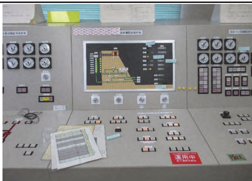
③ 樽水ダム 名取市高館川上字長畑地内 堰堤改良事業／管理用制御処理設備改良工事
