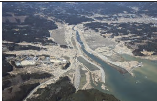
⑫ 津谷川 気仙沼市本吉町中島地内外 津谷川災害復旧工事
