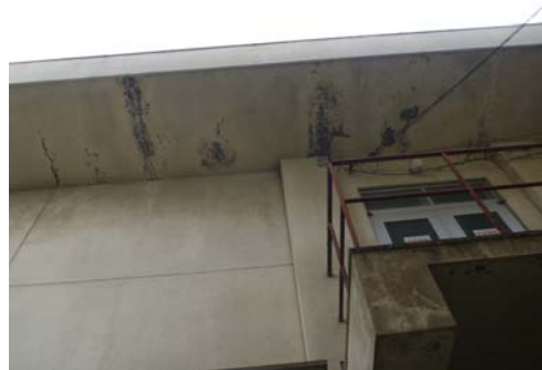
庇部分の雨漏り跡
