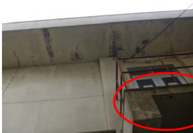
階段部分のひび割れ
