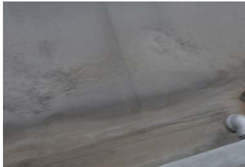
庇部分のシート防水と躯体の間に水が入っている
