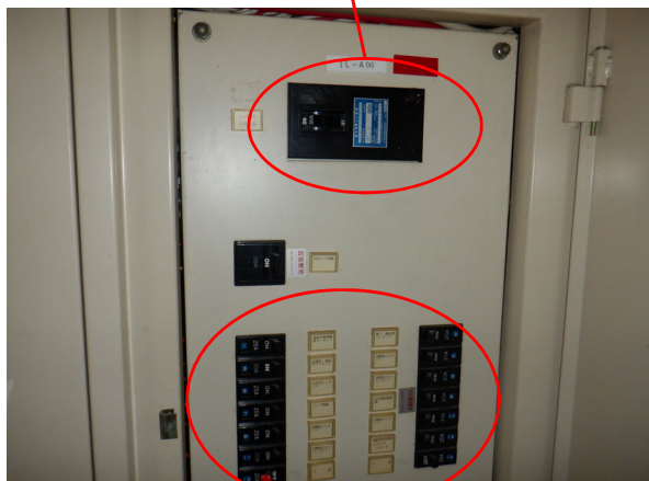
1L-B分電盤 子ブレーカー設置当初のまま
