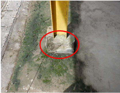
保護コンクリートの破損
