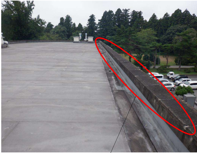
モルタル笠木に浮きが見られる。
