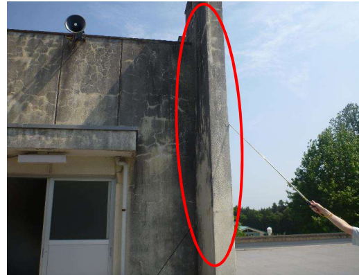
打診により浮きを確認
