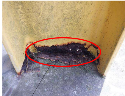
腐食および欠損部
