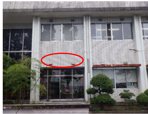
タイルが大きく浮いている箇所があります。
