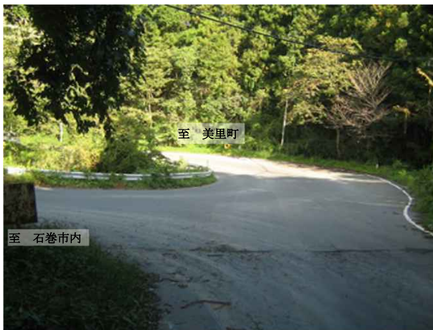
線形不良箇所
