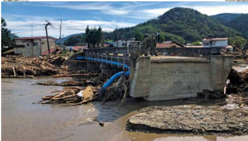
五福谷橋被災状況
