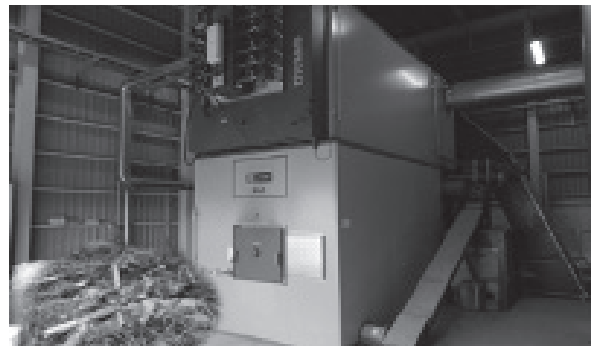
▲木質バイオマスボイラー
