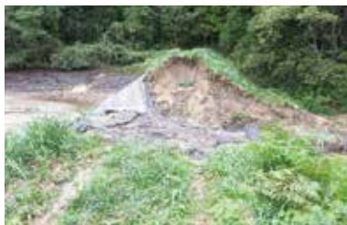
決壊した農業用ため池（白石市）
