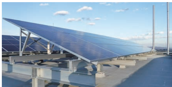
新庁舎屋上に設置した太陽光パネル
