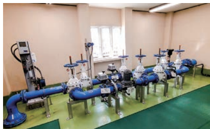
水力発電設備
