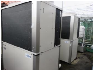
高効率空調機（室外機）
