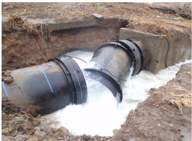
2.4mの伸縮可とう管がはずれ漏水
