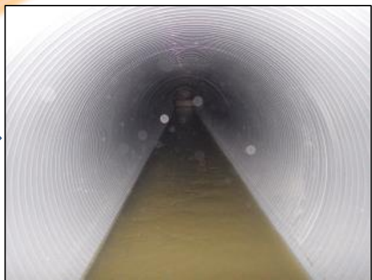
下水道管 (流域下水道管渠)
