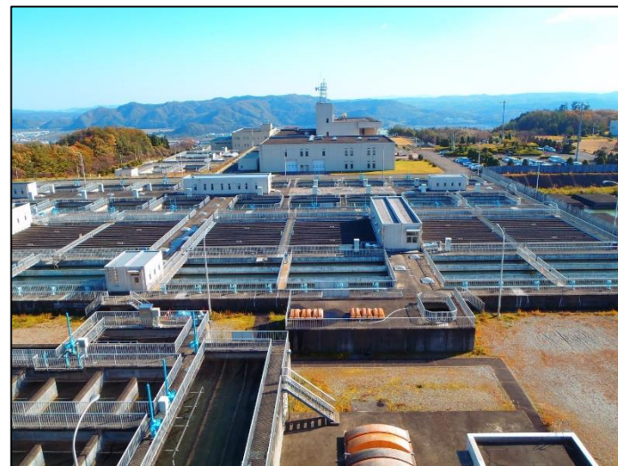
南部山浄水場(白石市内)
