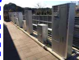
エネファーム (九大伊都に7台設置) 【家庭で発電効率40% 総合効率95%】
