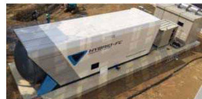
業務産業用・発電用燃料電池 (三菱日立パワーシステムズ製、九大伊都設置) 【将来、天然ガスで発電効率70%超】
