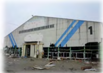
被災した木材加工施設
