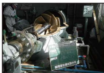
不來内排水機場全景(左)とポンプ整備状況(右)(不來内地区)
